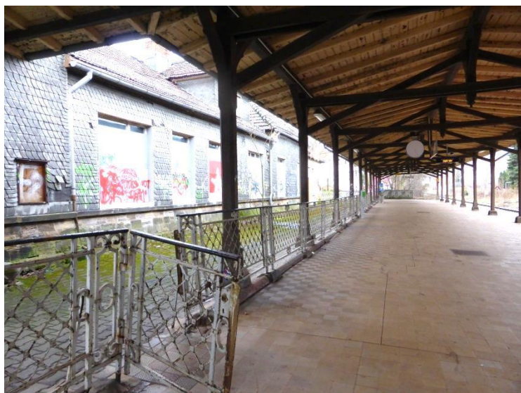
Baulicher Verfall am Bahnhof Friedrichroda
