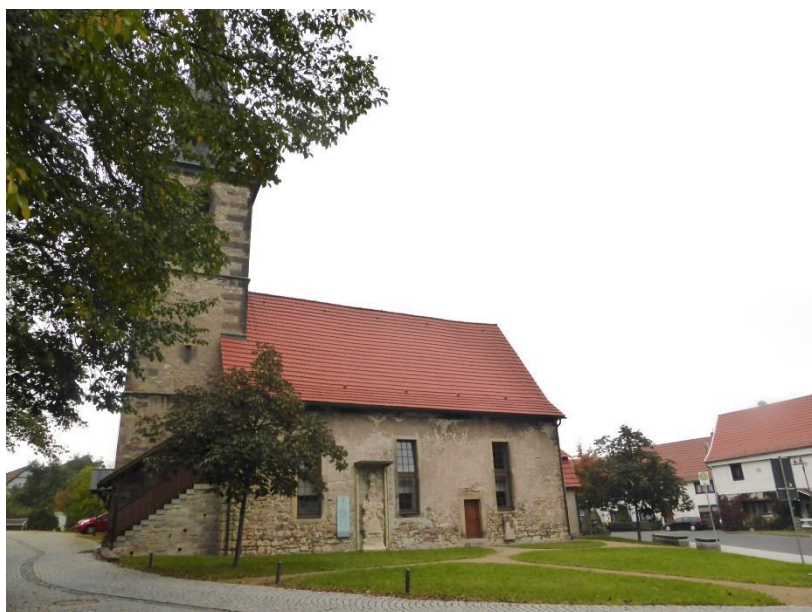
Kirchplatz in Ernstroda mit der denkmalgeschützten Kirche St. Katharina. Diese ist sanierungsbedürftig.
