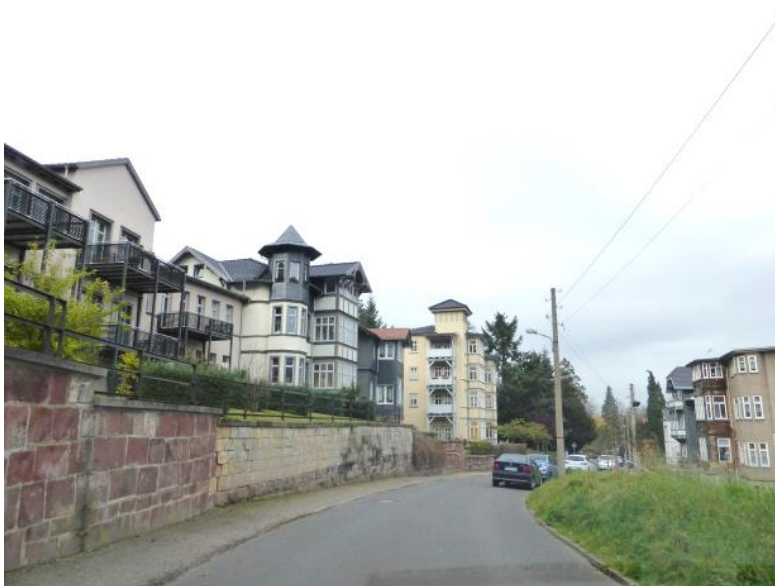
Westlich des Stadtzentrums befindet sich der Herzogsweg mit seinen großen Stadtvillen. Das hängige Gelände macht Natursteinmauern zur Abgrenzung der Grundstücke vom Straßenraum erforderlich. Diese ortstypischen Mauern stellen wegen ihres oft schlechten Bauzustandes vielfach ein Problem dar.
